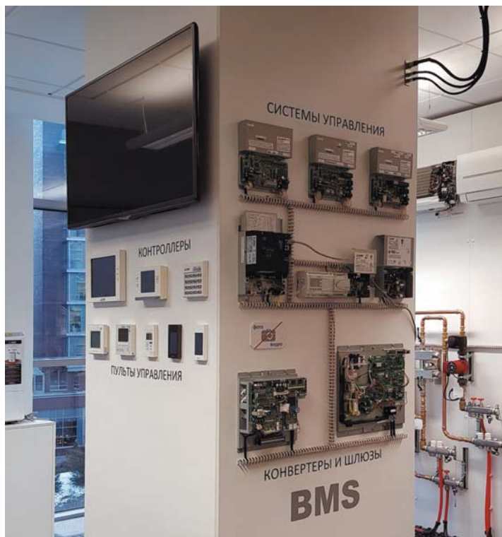
СИСТЕМЫ УПРАВЛЕНИЯ И ШЛЮЗЫ
